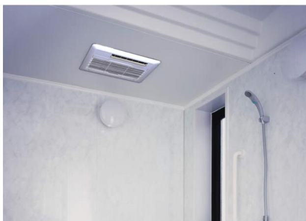
浴室の天井に設置
